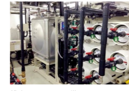
排水リサイクル設備
